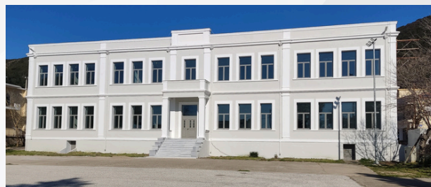
Ενεργειακή αναβάθμιση κτιρίου παλαιού δημοτικού σχολείου αλλαγής χρήσης σε Δημαρχείο Ιάσμου Ν. Ροδόπης
